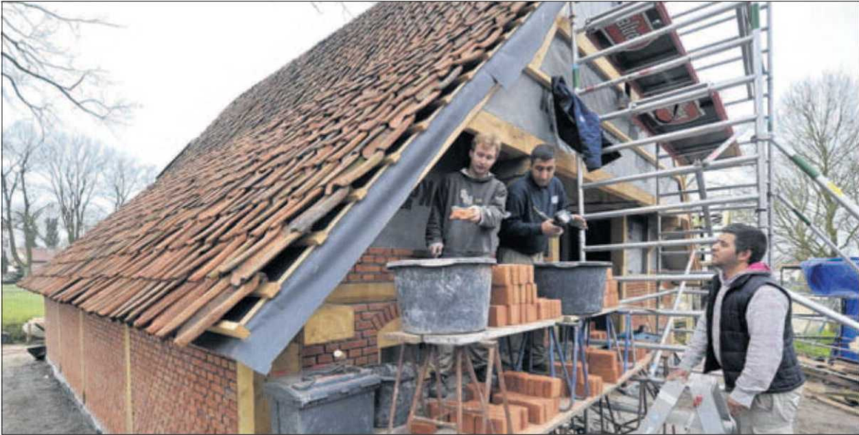
Jonge krachten van het werk- en leerbedrijf SWB uit Borne steken de handen flink uit de mouwen bij de restauratie van de vakwerkschuur.
